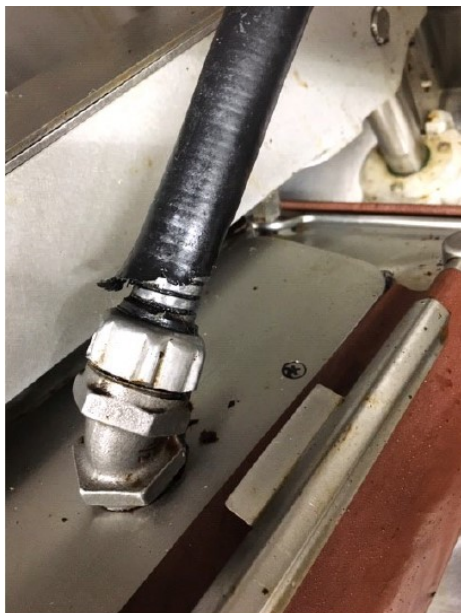
beschädigter ATX Schlauch
