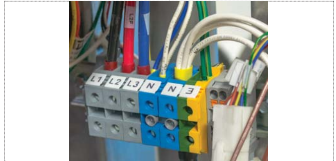
2. Blok terminala za WYE napajanje.
